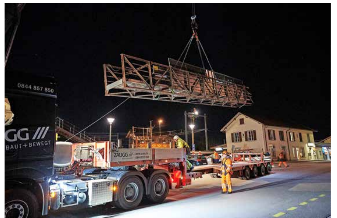
Der Tieflader transportiert die Stahlwerkbrücke nach Oensingen im Kanton Solothurn in ein Sandstrahlwerk.
